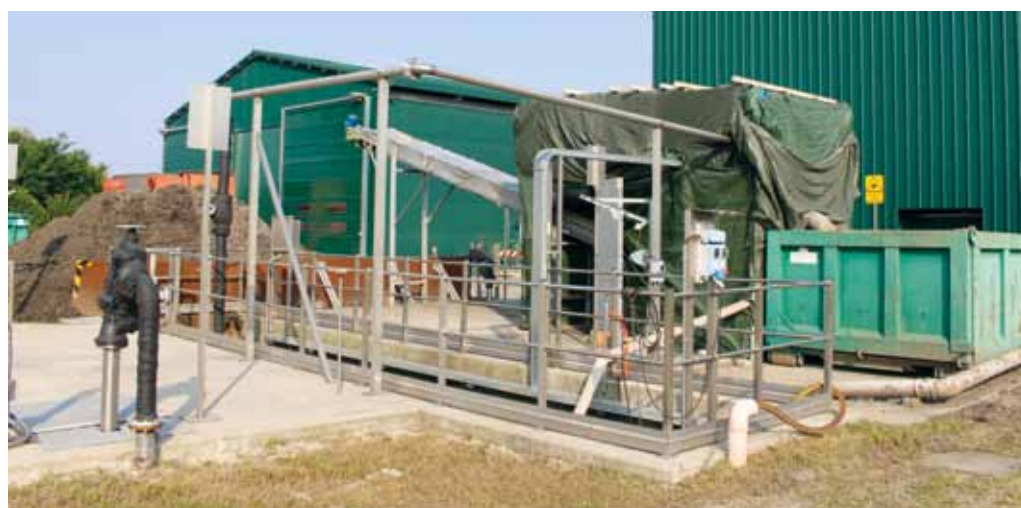
Impianto recupero e riciclo sabbie, Limena
