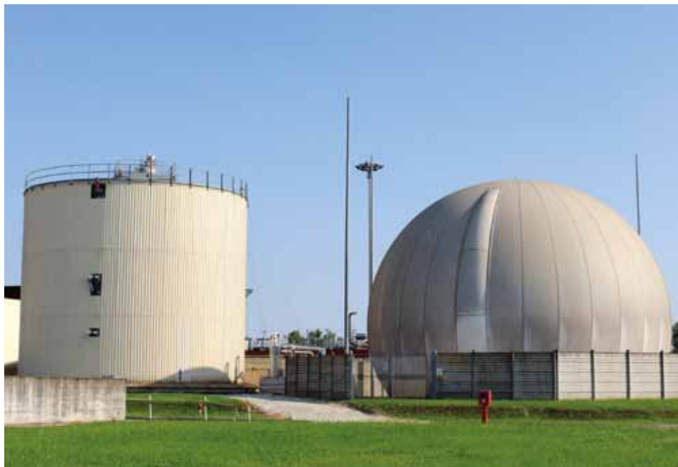
Digestore e gasometro Centro biotratamenti, Camposampiero
