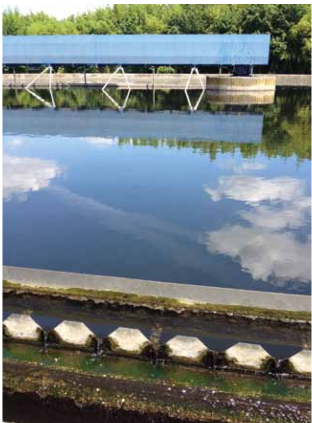
Impianto depurazione, Vigonza
