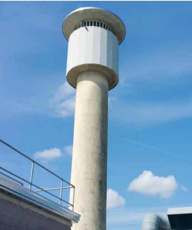
Torre piezometrica Centrale idrica di Fratte, Santa Giustina in Colle
