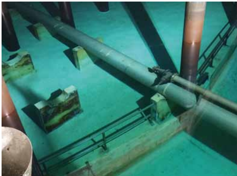
Vasca di accumulo Centrale idrica di Fratte, Santa Giustina in Colle
