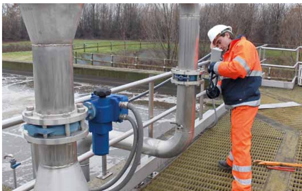
Attività di controllo al depuratore
