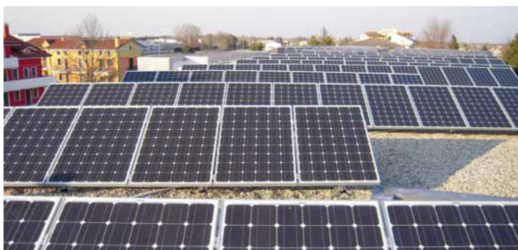
Impianto fotovoltaico, Vigodarzere
