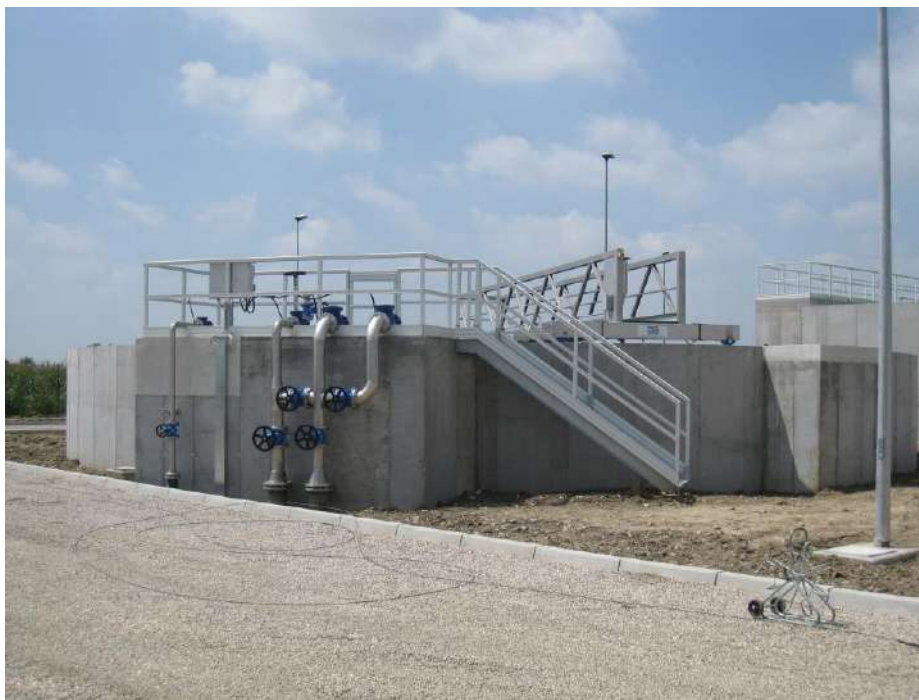
(Nuovo impianto di depurazione di Santa Margherita d'Adige)
